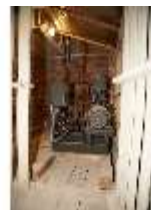
HchNS.II, Raum mit technischem Apparat, DI023683, BSV-
