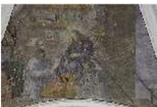
HchAS.II, Inseldom, Detail Fresko vor der Sanierung 2019, DI014882, BSV-
