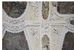
HchAS.II, Inseldom, Detail Decke vor der Sanierung 2019, DI014883, BSV-
